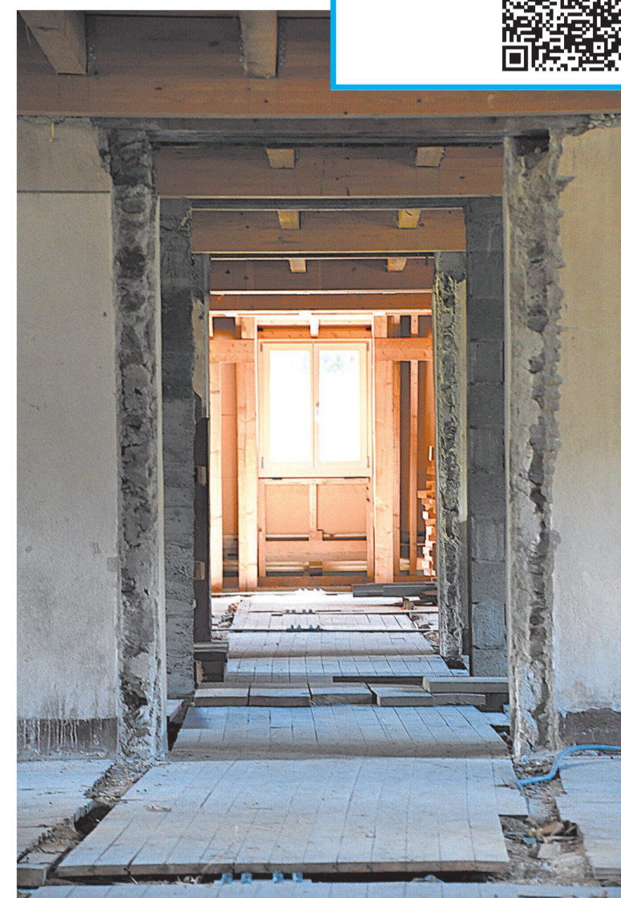
Einer der langgezogenen Gänge, links und rechts die alten Zimmer, geradeaus eines der vielen komplett sanierten Fenster.
